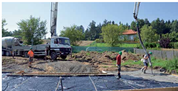
9:45 hod. – na stavbě: Příjezd prvního mixu na stavbu, začíná betonáž (čerpání betonu na plochu budoucí základové desky rodinného domu)
