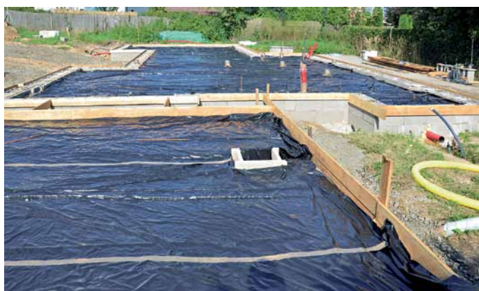
8:00 hod. – na stavbě: Bylo dokončeno ošetření separací zhuštěného podloží a nastavení výšky 20 cm základové desky před samotnou betonáží v celé ploše budoucích betonových základů rodinného domu
