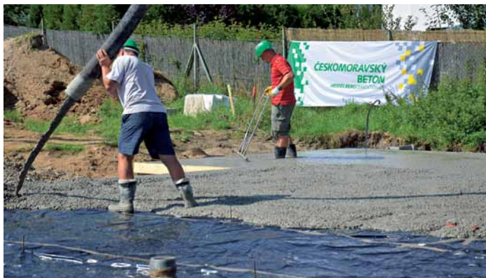
10:00 hod. – na stavbě: Pokračuje betonáž současně se zpracováním do roviny základové desky
